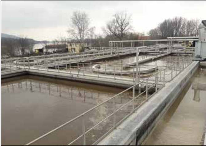
Die neue biologische Stufe hat bereits den Betrieb aufgenommen.
